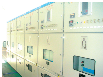
沈阳新城子农电局 智能化变电站 使用ISM-20kA/630A 2005年投产成套厂：沈阳成兴电气
