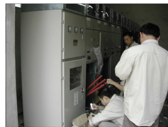
北京朝阳供电局2004年投入运行 使用ISM-20kA/630A
